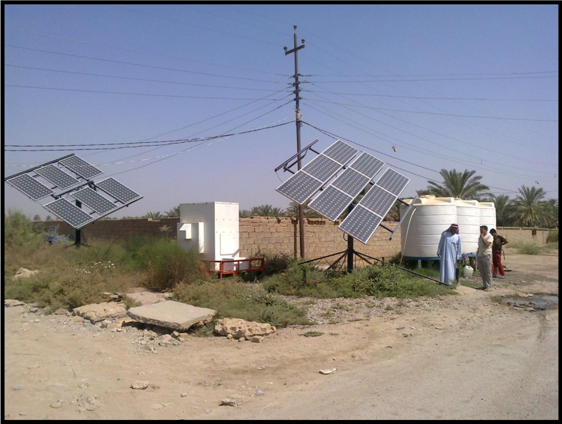
صورة (١٩) محطة تصفية مياه تعمل بالطاقة الشمسية في مستوطنة حد مكسر
